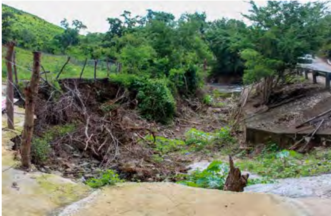
Damage after heavy rains in Salinas, a southern coastal region of Puerto Rico. / Daños tras fuertes lluvias en Salinas, una región costera en el sur de Puerto Rico. (Photo/Foto: Kavitha Cardoza for The Hechinger Report)
